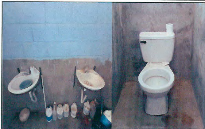
Foto 1: servicios sanitarios y sus accesorios
